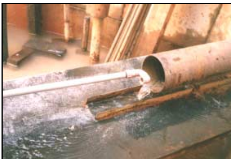
Foto 10 - Sistema de limpeza com jato invertido
