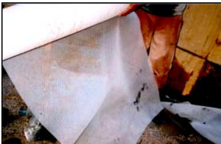
Foto 21 - Telas de nylon para retenção de sólidos para dentro do poço coletor
