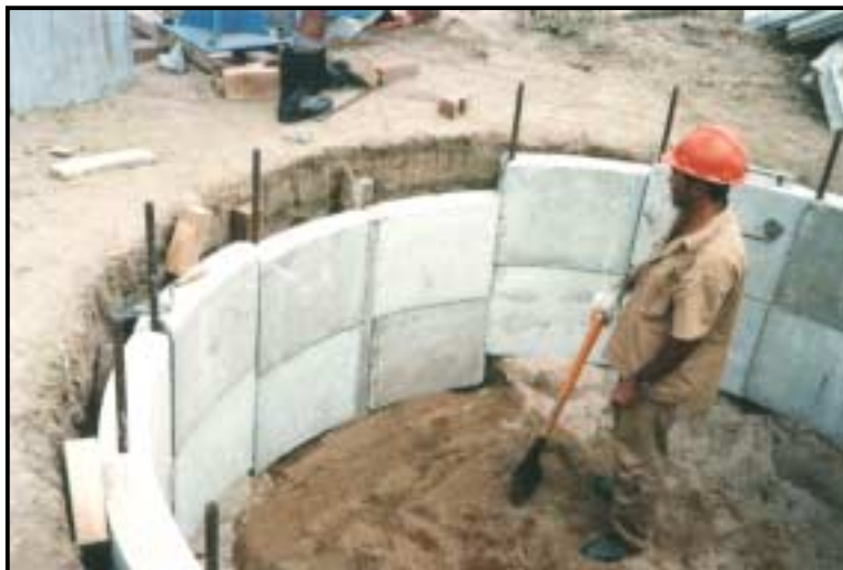
Foto 4 - Início da montagem dos blocos pré-moldados e escavação manual, observando-se, na vertical, os "centralizadores" responsáveis pela estabilização dos blocos
