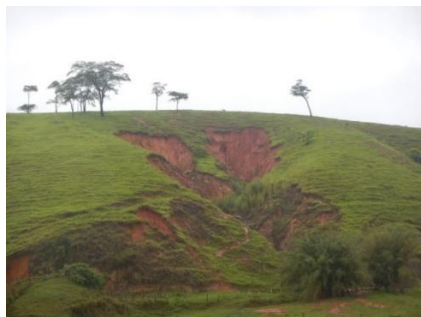
Encosta com suscetibilidade a deslizamentos planares - Município de Paty do Alferes- RJ
